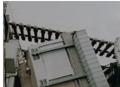
崩れた新幹線の高架橋
